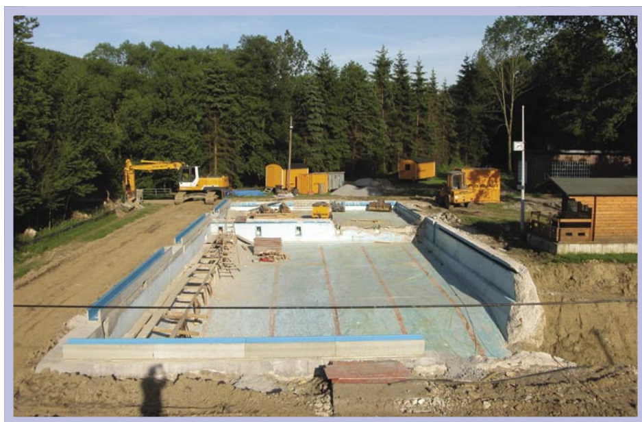
Die Überlaufrinnen sind vorbereitet, der Durchbruch für den Erlebnisbereich und die Verbindung zwischen Schwimm- und Reinigungsbereich sind geschaffen. Umfangreiche Betonarbeiten sind zur Umgestaltung eines Schwimmbades in einen Schwimmteich notwendig.
