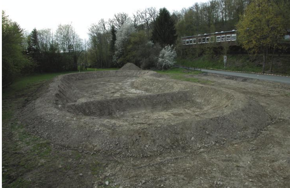
Durch die Werthe vom eigentlichen Bad getrennt: Der Aufbereitungsbereich musste über eine aufwendige Verrohrung mit dem Schwimmbereich verbunden werden.
