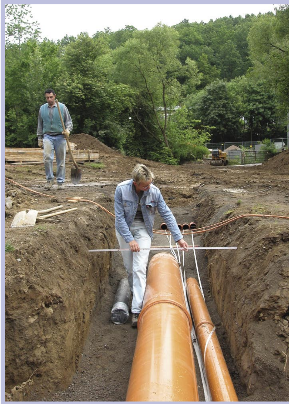
Zur Verbindung des Aufbereitungsbereiches mit dem eigentlichen Schwimmbereich musste die Werthe mit einem Rohrgraben unterquert werden.
