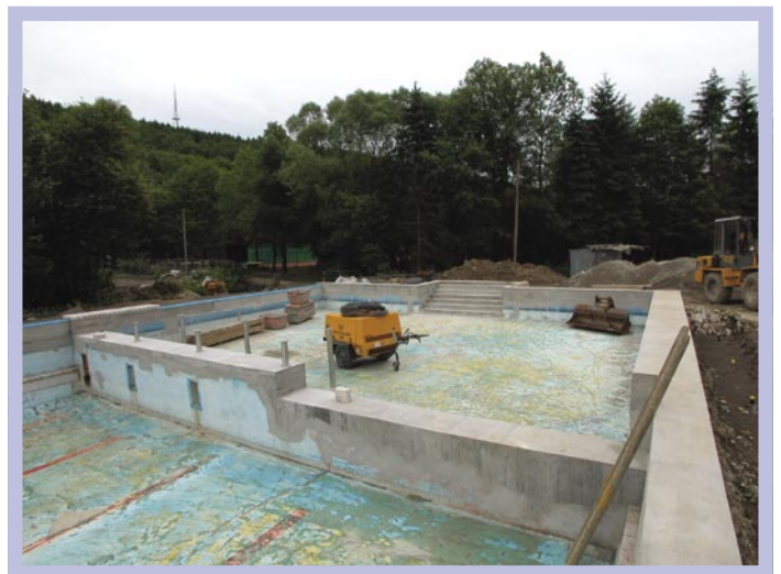
Die Trennwand zwischen Schwimmer- und Nichtschwimmerbereich wurde teilweise unterbrochen. Deutlich sichtbar sind die Stützen für die Steganlage.
